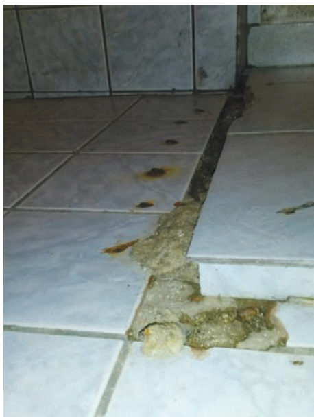
Slika 5. Problem procurivanja vode ispod poda u podrumu
