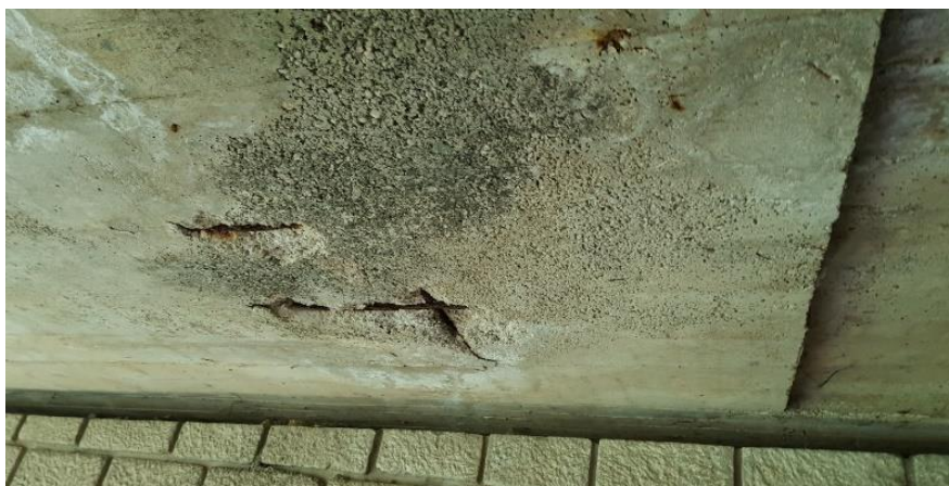
Slika 40. Segregacija betona i korozija armature u podgledu na ploču u polju neposredno uz drugi upornjak
