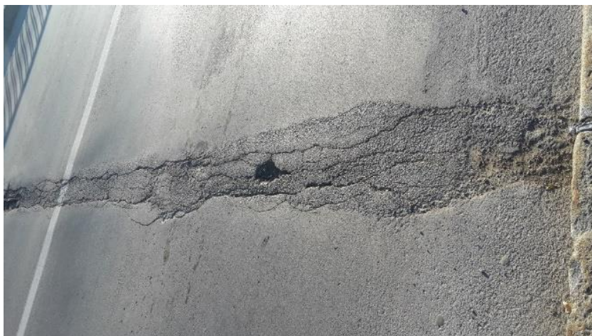
Slika 15. Dilatacije i pukotine na prijelaznoj napravi mosta preko Korane
