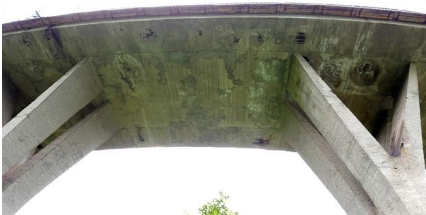
Slika 38. Odlamanje zaštitnog sloja, iscvjetavanje betona (dijelom sanirano) na podgledu nosive konstrukcije
