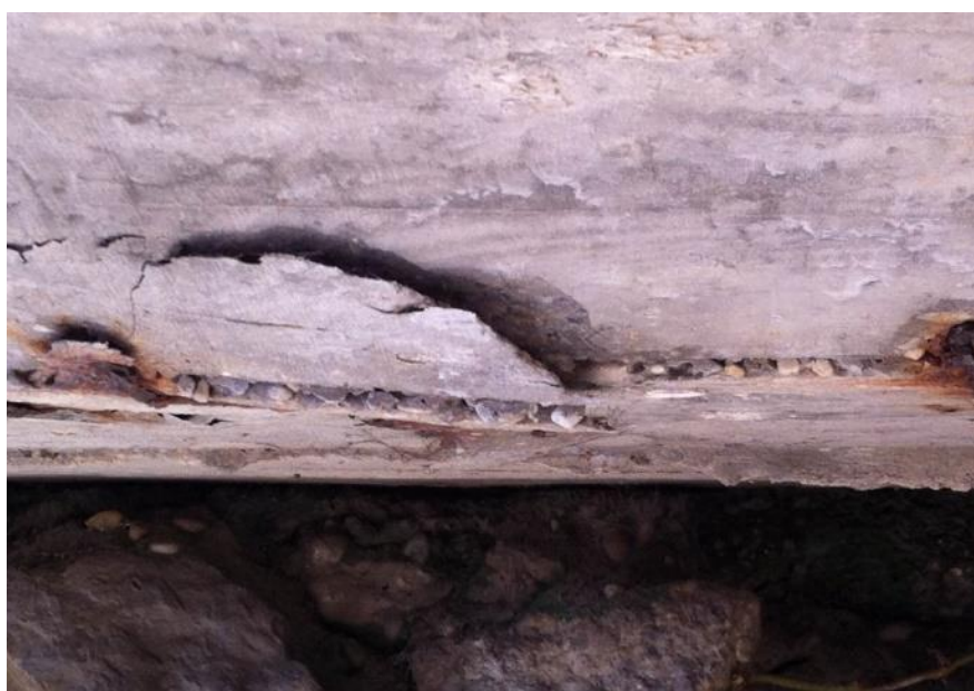
Slika 44. Prikaz odlamanja betona ploče
