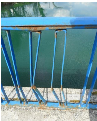
Slika 45. Oštećenje ograde: mehaničko oštećenje i korozija
