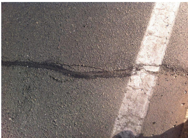
Slika 41. Sanirana, naknadno otvorena pukotina u asfaltu
