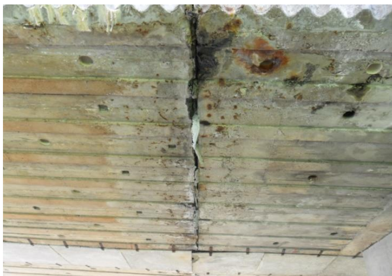
Slika 47. Dilatacija i iscvjetavanje na glavnom nosaču
