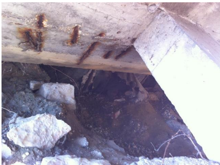
Slika 42. Korozijska armature ploče glavnog nosača
