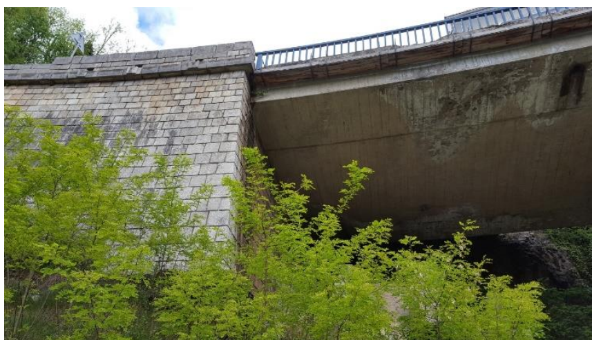
Slika 39. Iscvjetavanje betona u podgledu nosive pločaste konstrukcije mosta blizu prvoga upornjaka
