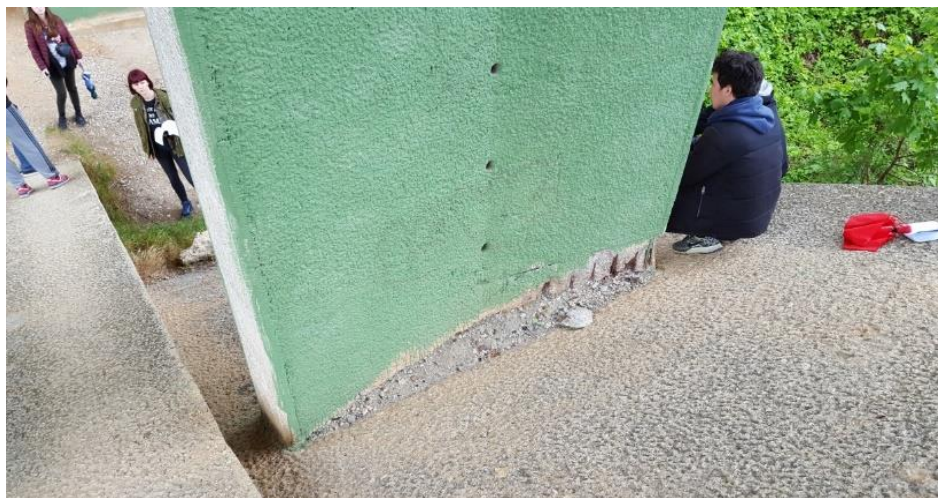
Slika 34. Korozija i odlamanje zaštitnog sloja betona na stupu
