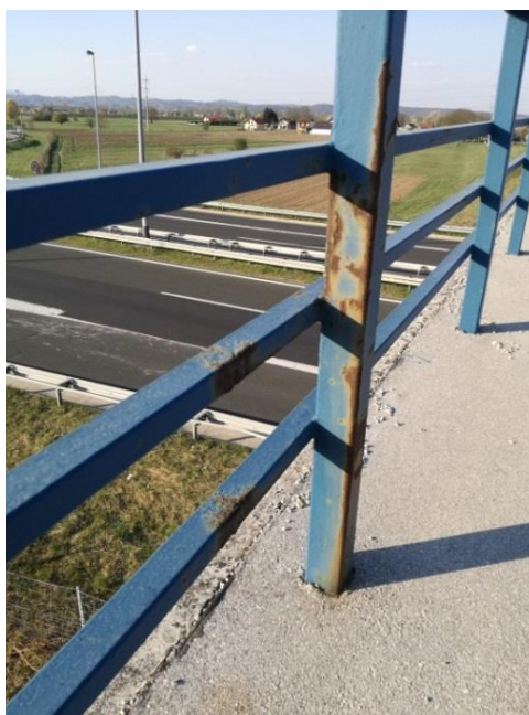
Slika 17. Korozija ograde na nadvožnjaku Gradna
