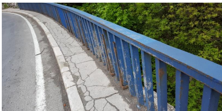
Slika 36. Korozija ograde, oštećenje hodnika
