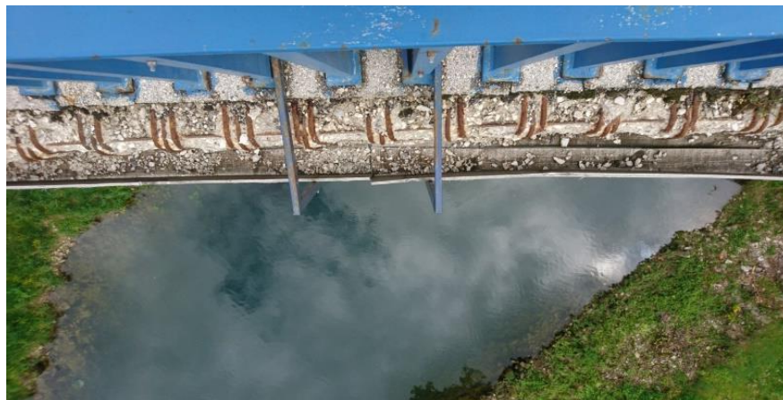
Slika 37. Korozijska armatura te odlamanje vijenca
