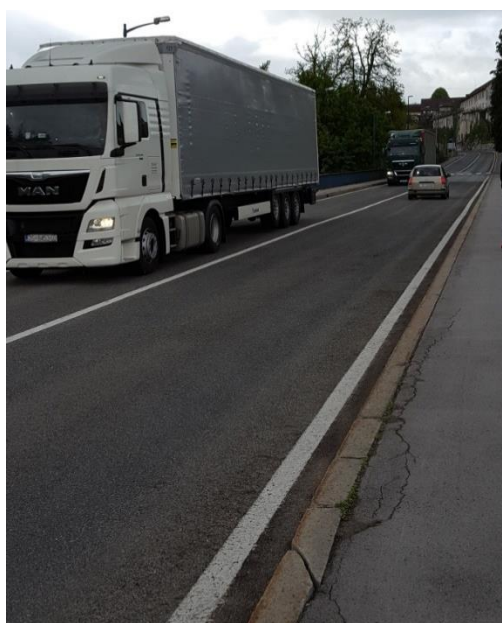
Slika 35. Mrežaste pukotine na pješačkom hodniku
