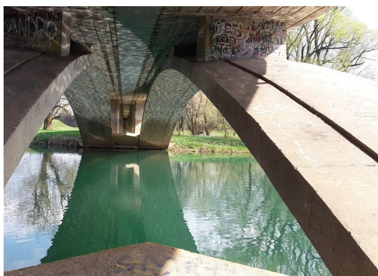
Slika 49. Lučna konstrukcija mosta s neznatnim oštećenjima
