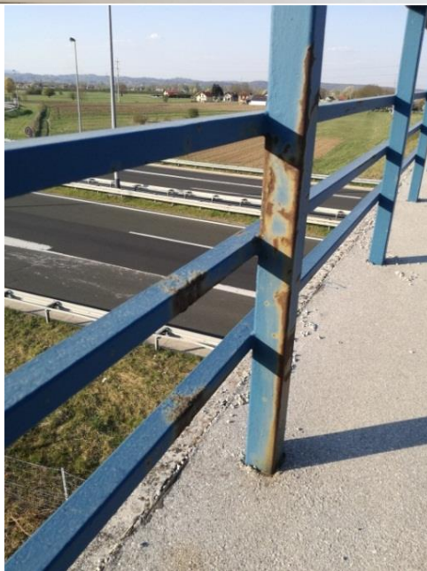
Slika 50. Korozija pješačke ograde
