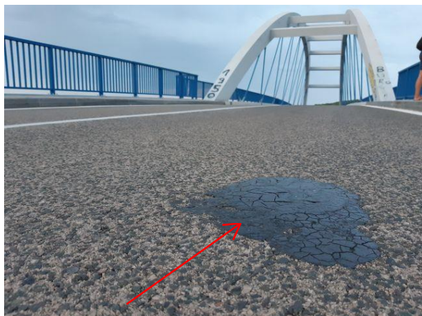
Slika 134. „Zakrpa“ asfalta kolnika. Stupanj oštećenja S2.
