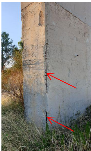
Slika 102. Stup S7 – nedovoljan zaštitni sloj betona. Stupanj oštećenja S3.
