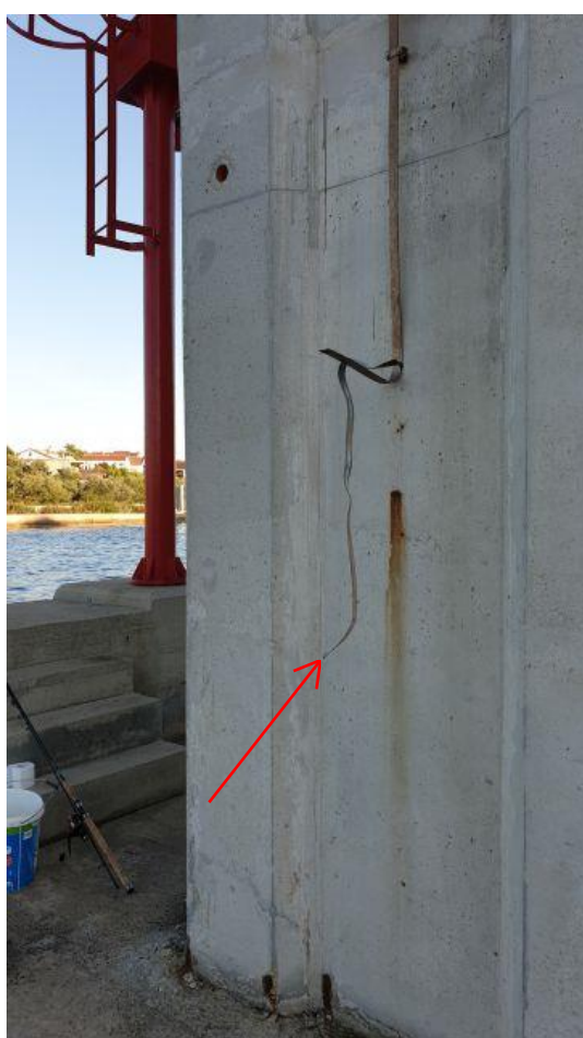
Slika 183. Uništeno uzemljenje konstrukcije na stupu S6.
