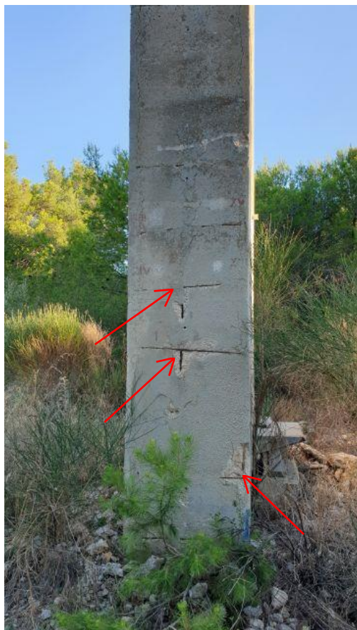
Slika 98. Oštećenje stupa S9 – korozija. Stupanj oštećenja S3.
