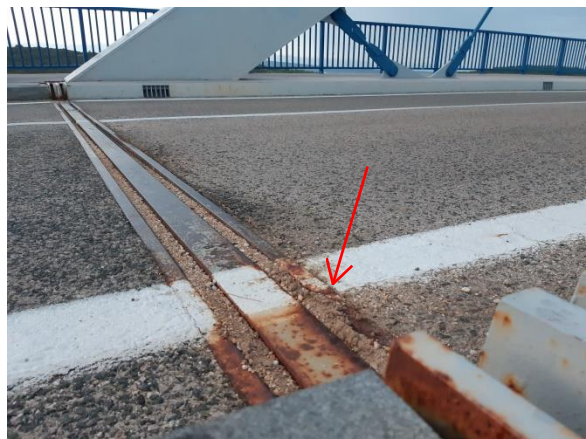
Slika 122. Propadanje prijelazne naprave zbog lošeg održavanja. Stupanj oštećenja S2.
