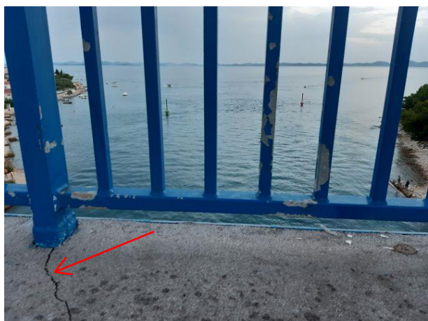
Slika 154. Pukotine u asfaltu uz ogradu
