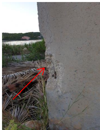
Slika 87. Odlamanje zaštitnog sloja betona stupa S1. Stupanj oštećenja S3.
