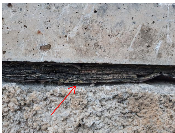
Slika 149. Drveni podmetači. Stupanj oštećenja S4.
