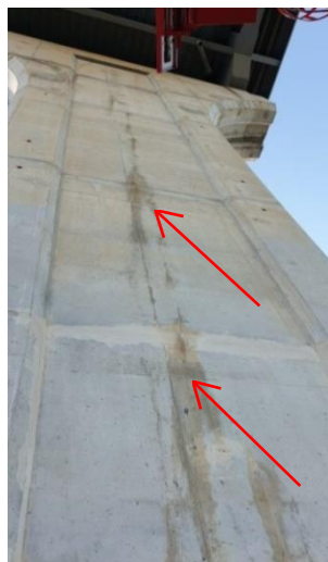
Slika 103. Stup S6 –curenje vode s gornjeg ustroja. Stupanj oštećenja S2.
