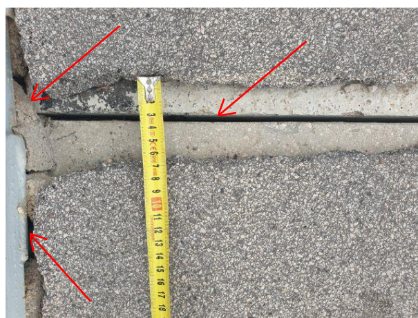
Slika 141. Pukotina na spoju montažnih ploča. Stupanj oštećenja S4.
