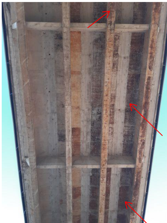
Slika 116. Vlaženje betona uzrokovano oštećenom hidroizolacijom. Stupanj oštećenja S3.
