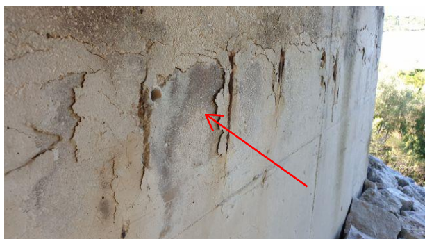
Slika 96. Oštećenje upornjaka U2 – ljuštenje. Stupanj oštećenja S3.
