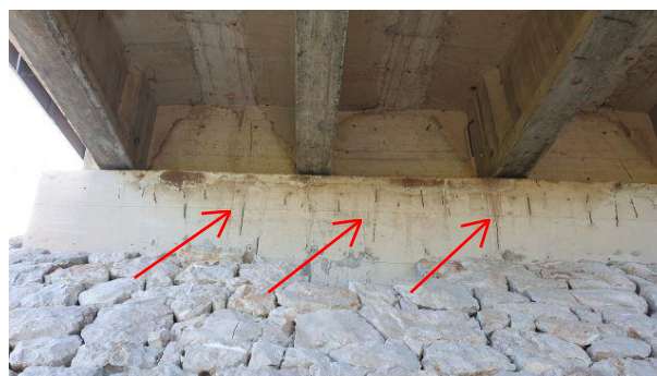
Slika 95. Oštećenje upornjaka U2 – pukotine. Stupanj oštećenja S3.
