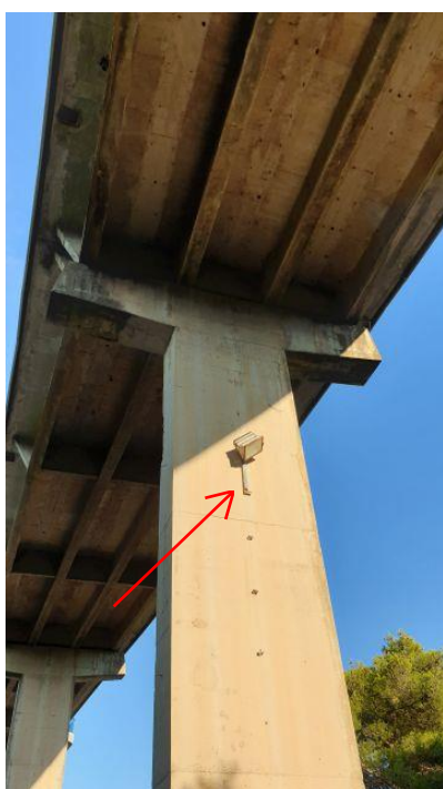
Slika 178. Nedostajanje strujnih kablova na stupu S8. Stupanj oštećenja S5.
