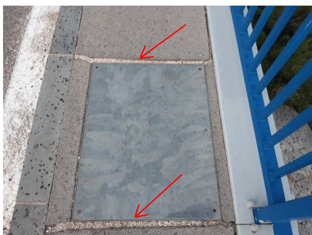
Slika 142. Pukotine uz revizijska okna. Stupanj oštećenja S4.
