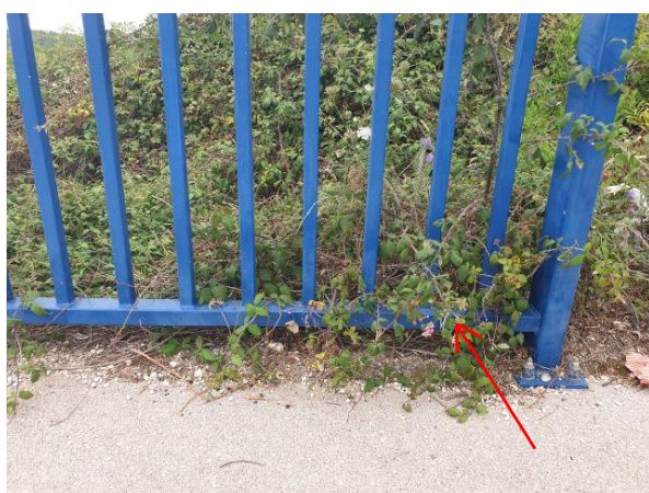
Slika 150. Raslinje uz ogradu. Stupanj oštećenja S1.
