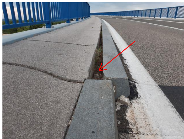
Slika 157. Loše postavljene rubnjake u krivini. Stupanj oštećenja S4.
