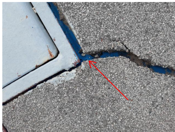
Slika 145. Pukotina uz slivnik. Stupanj oštećenja S4.
