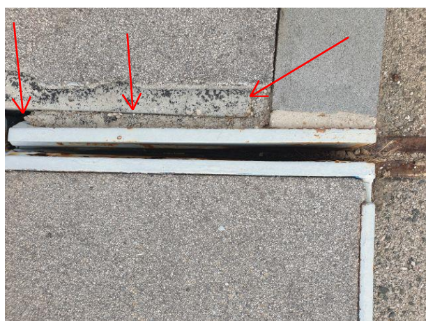
Slika 125. Loše izveden spoj prijelazne naprave i hodnika. Stupanj oštećenja S3.
