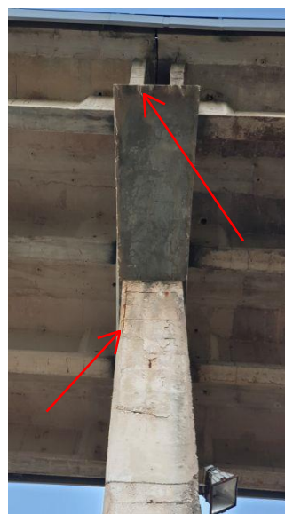
Slika 107. Stup S2 – lomljenje uslijed korozije. Stupanj oštećenja S3.
