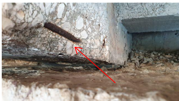
Slika 114. Delaminacija donje pojasnice betonskog nosača. Stupanj oštećenja S2.
