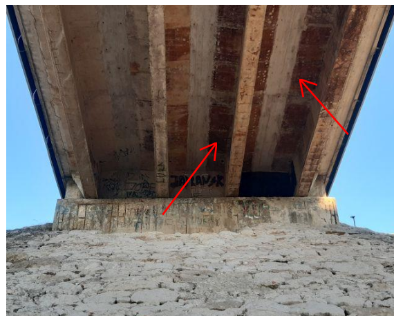
Slika 173. Oštećenje hidroizolacije kolničke konstrukcije. Stupanj oštećenja S3.
