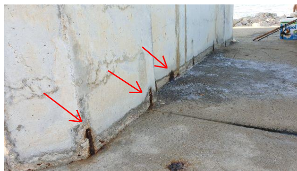
Slika 89. Korozija armature stupa S6 u blizini mora. Stupanj oštećenja S3.
