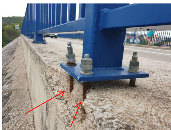
Slika 151. Nedostajanje pričvršćenja ograde. Stupanj oštećenja S3.
