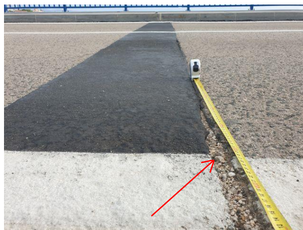
Slika 127. Propusnost bitumenske dilatacijske naprave. Stupanj oštećenja S3.
