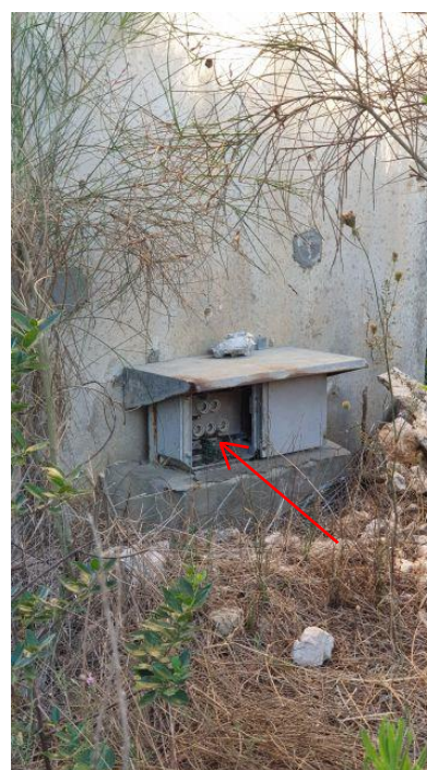
Slika 179. Nefunkcionalan strujni ormarić na stupu S8. Stupanj oštećenja S5.
