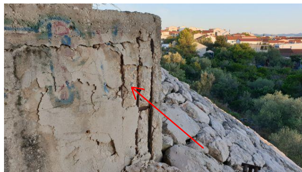
Slika 93. Upornjak U1 – delaminacija i ljuštenje betona. Stupanj oštećenja S4.
