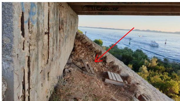
Slika 82. Upornjak U1- erozija kosine nasipa. Stupanj oštećenja S4.
