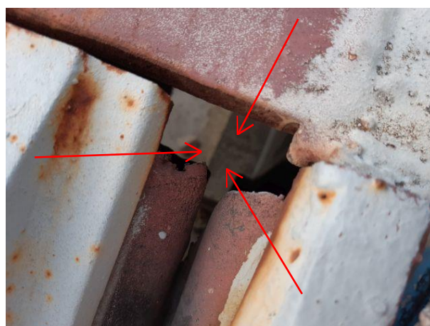
Slika 124. Loše riješen detalj dilatacije na pješačkoj stazi. Stupanj oštećenja S3.
