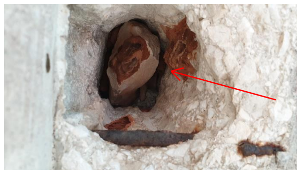
Slika 165. Oštećenje odvodne cijevi. Stupanj oštećenja S5.
