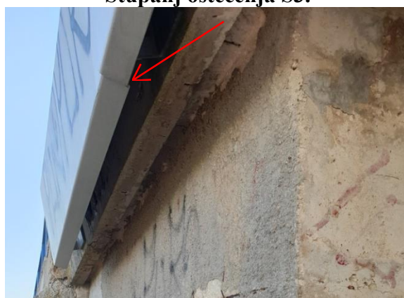
Slika 169. Odstupanje maske od ravnosti zbog loših ili nedostajućih vijčanih spojeva. Stupanj oštećenja S2.
