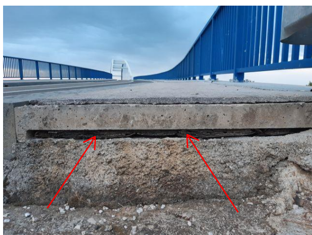
Slika 148. Drveni podmetači ispod betonskih ploča. Stupanj oštećenja S4.
