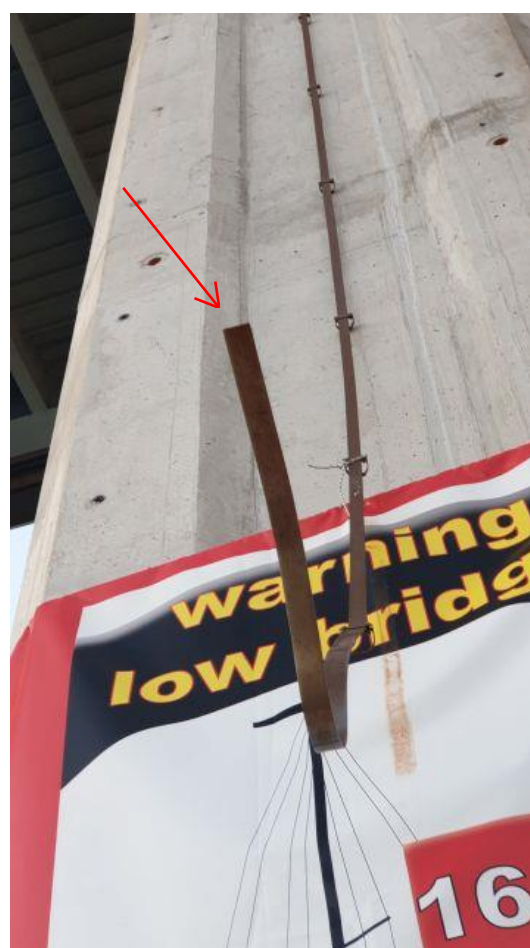
Slika 184. Uzemljenje na stupu S3 van funkcije.
