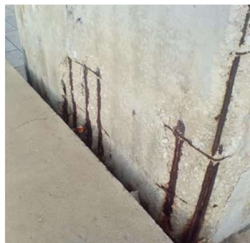
Slika 39. Odlamanje betona S4 (2008.)
