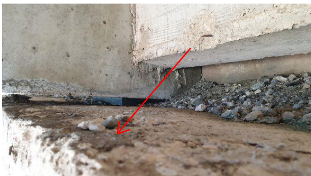
Slika 128. Hrapavost ležajne klupe na upornjaku U2. Stupanj oštećenja S3.
