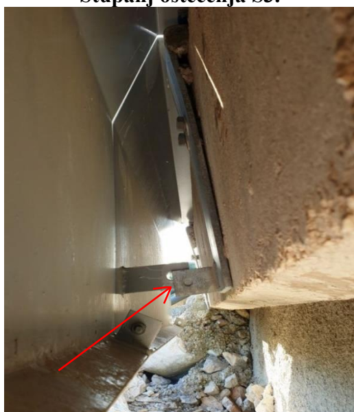
Slika 170. Loše izvedeni vijčani spojevi maske. Stupanj oštećenja S2.
