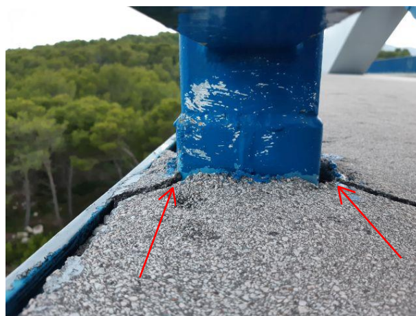
Slika 155. Pukotine u asfaltu oko ograde
