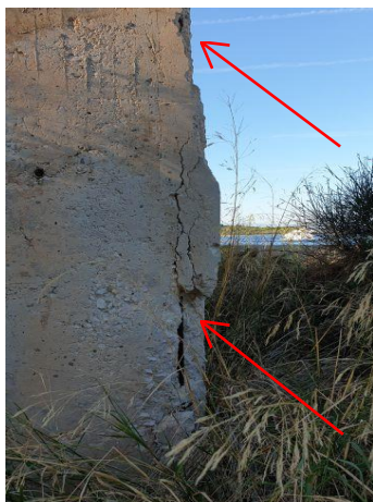
Slika 86. Delaminacija na stupu S8. Stupanj oštećenja S4.
