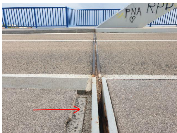
Slika 147. Loše izveden spoj asfalta i prijelazne naprave. Stupanj oštećenja S4.
