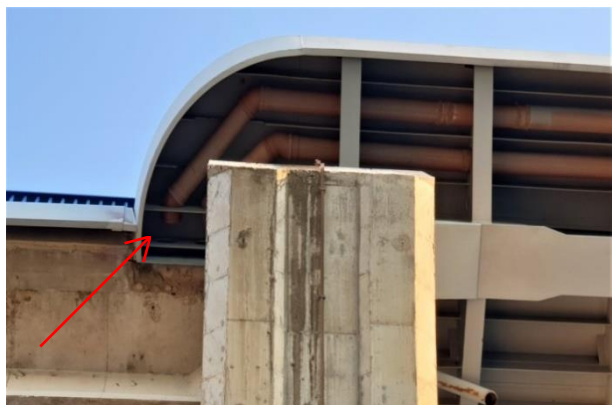
Slika 181. Vodovodne cijevi van funkcije.
