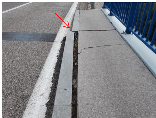
Slika 159. Loše postavljene rubnjake. Stupanj oštećenja S4.
