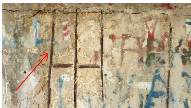
Slika 94. Oštećenje upornjaka U1- korozija armature. Stupanj oštećenja S4.
