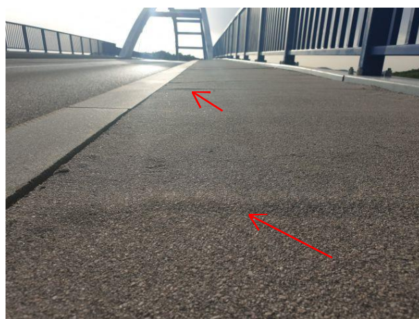
Slika 143. Oštećenje pješačkog hodnika u obliku boranja. Stupanj oštećenja S3.
