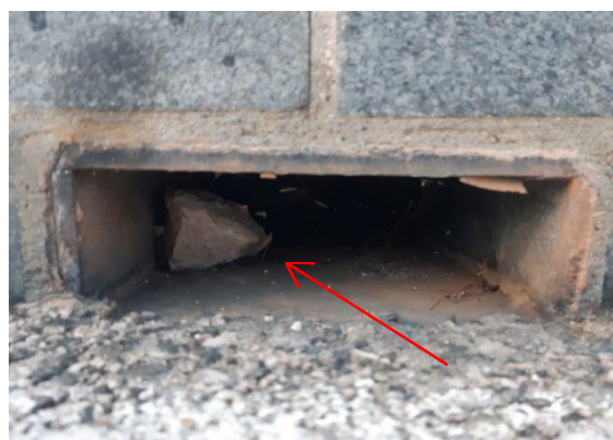
Slika 163. Slivnik zapunjen kamenjem. Stupanj oštećenja S2.
