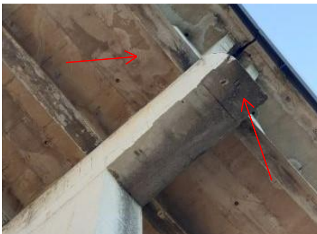
Slika 172. Oštećenje hidroizolacije kolničke konstrukcije. Stupanj oštećenja S3.
