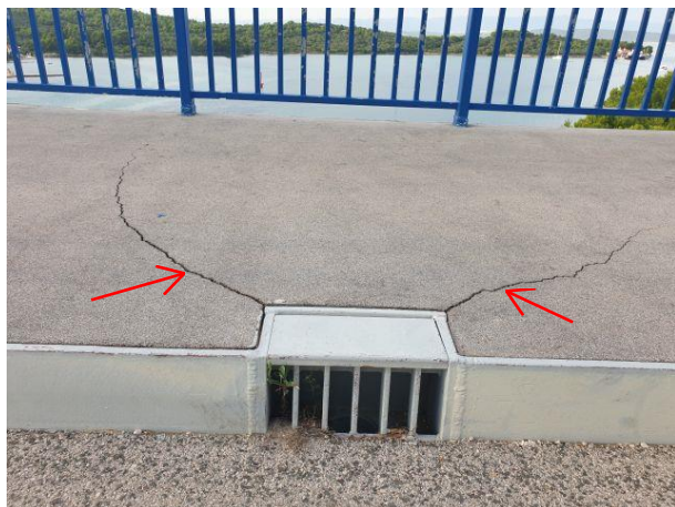
Slika 144. Pukotine uz slivnik. Stupanj oštećenja S4.
