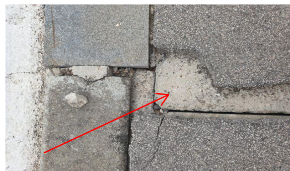
Slika 85. Pukotine završnog sloja hodnika. Stupanj oštećenja S3.
