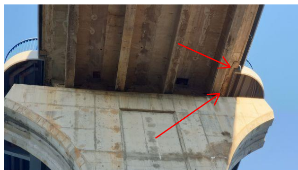
Slika 115. Delaminacija na desnom rubu betonske rasponske konstrukcije uslijed alkalno-silicijske reakcije. Stupanj oštećenja S3.
