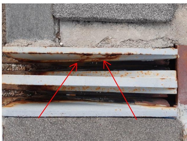
Slika 123. Propadanje prijelazne naprave zbog lošeg održavanja. Stup. oštećenja S2.
