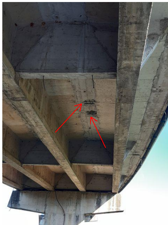
Slika 117. Segregacija betona. Stupanj oštećenja S2.
