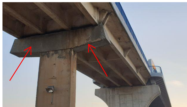
Slika 109. Naglavnica stupa S2 – oštećenje zbog vlaženja. Stupanj oštećenja S3.
