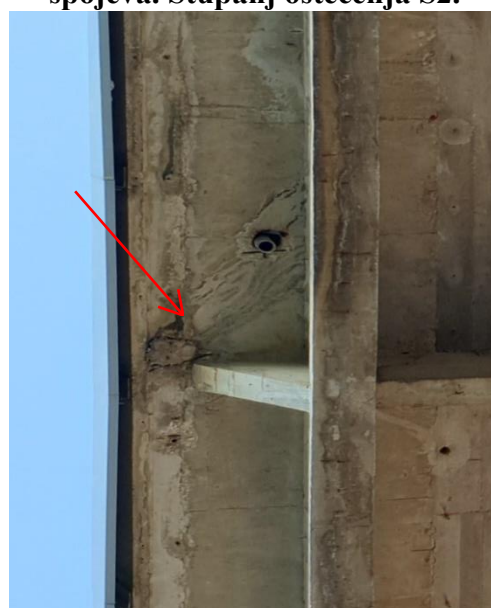
Slika 171. Curenje vode. Stupanj oštećenja S2.
