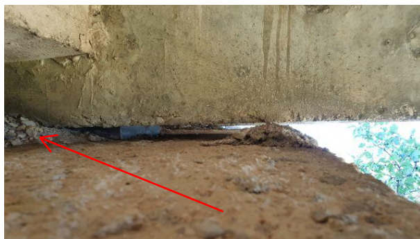
Slika 129. Drobljenje betona uz ležaj na upornjaku U2. Stupanj oštećenja S2.
