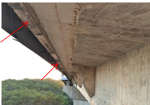
Slika 168. Eflorescencija uzrokovana curenjem vode s pješačkog hodnika. Stupanj oštećenja S3.
