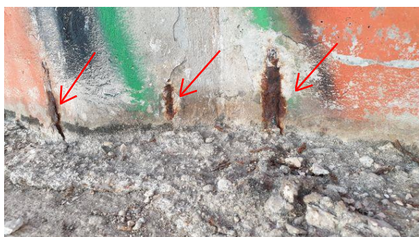
Slika 90. Korozija armature stupa S3 u blizini mora. Stupanj oštećenja S3.
