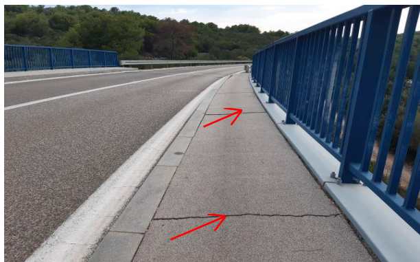
Slika 138. Pješački hodnik. Stupanj oštećenja S4.
