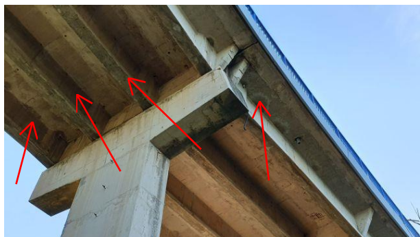
Slika 110. Vlaženje donje strane kolnika mosta. Stupanj oštećenja S2.
