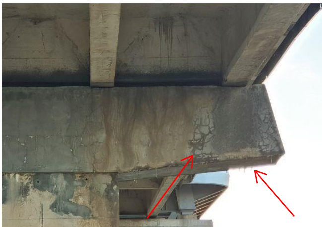
Slika 174. Oštećenje hidroizolacije kolničke konstrukcije. Stupanj oštećenja S4.
