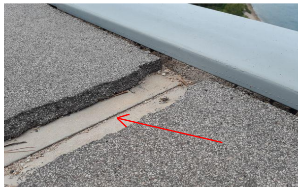
Slika 139. Pukotina na asfaltnom zastoru. Stupanj oštećenja S4.
