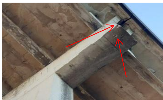
Slika 104. Naglavnica stupa S7 – ljuštenje usred korozije. Stupanj oštećenja S2.
