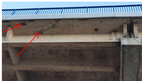
Slika 111. Procjeđivanje vode zbog lošeg sustava odvodnje. Stupanj oštećenja S2.
