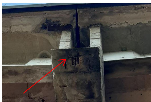
Stupa 101. Naglavnica stupa S8 – oštećenja uslijed vlaženja betona. Stupanj oštećenja S3.
