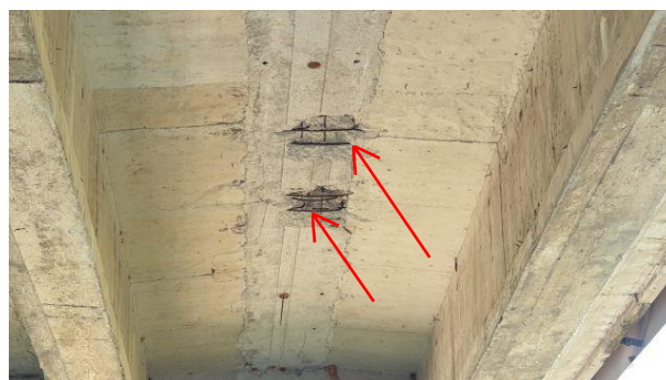
Slika 113. Korozija armature koja uzrokuje lomljenje i delaminaciju zaštitnog sloja. Stupanj oštećenja S3.
