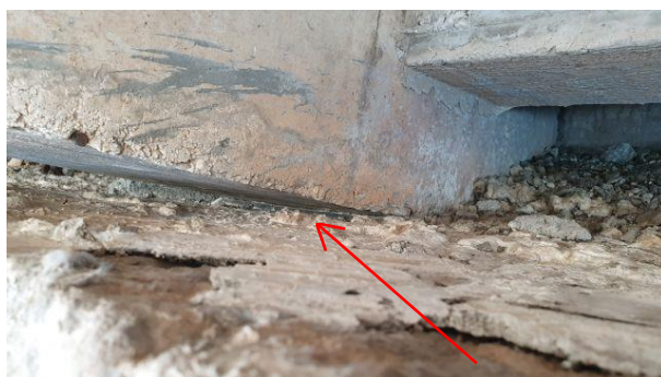
Slika 131. Elastomerni ležaj upornjaka U1 u potpunosti deformiran. Nosač je praktički oslonjen na beton. Stupanj oštećenja S4.
