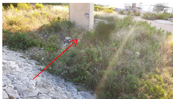
Slika 91. Vegetacijom obrasli temelji stupa S2. Stupanj oštećenja S2.
