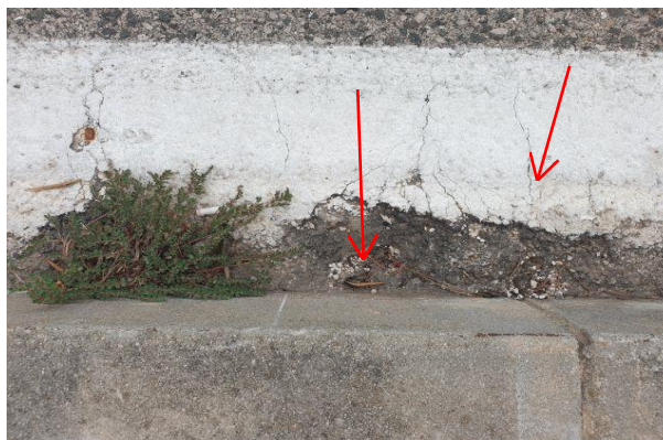
Slika 137. Spoj asfaltnog sloja i rubnjaka. Pojedinačne pukotine na spoju. Stupanj oštećenja S2.
