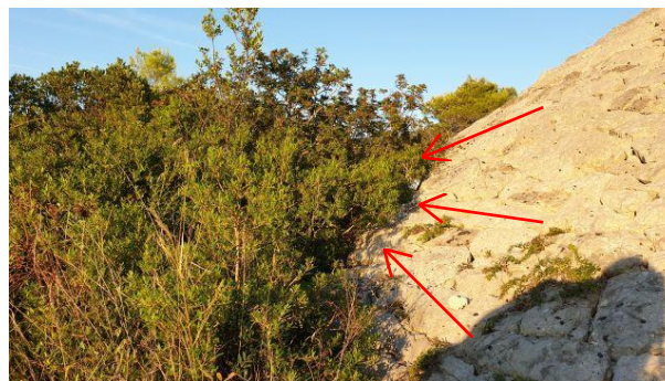
Slika 83. Vegetacija na upornjaku U1. Stupanj oštećenja S2.
