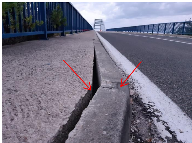
Slika 156. Oštećenja montažnih rubnjaka pješačkih hodnika. Stupanj oštećenja S3.
