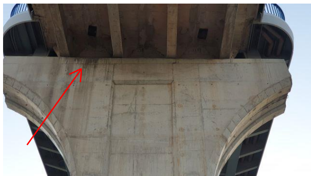
Slika 108. Naglav. stupa S3 – curenje vode s gornjeg ustroja. Stupanj oštećenja S1.
