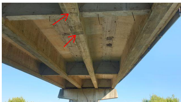
Slika 112. Korozija armature na donjoj pojasnici nosača i na spoju između 2 nosača. Stupanj oštećenja S2.
