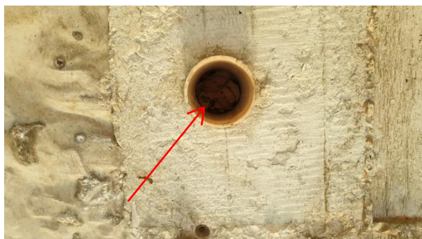
Slika 164. Osinjak u odvodnoj cijevi. Stupanj oštećenja S4.
