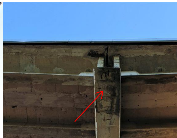
Slika 175. Oštećenje hidroizolacije kolničke konstrukcije. Stupanj oštećenja S4.
