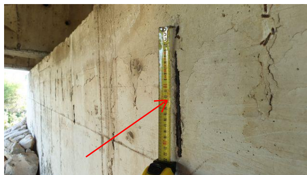
Slika 97. Oštećenje upornjaka U2 – korozija armature. Stupanj oštećenja S3.
