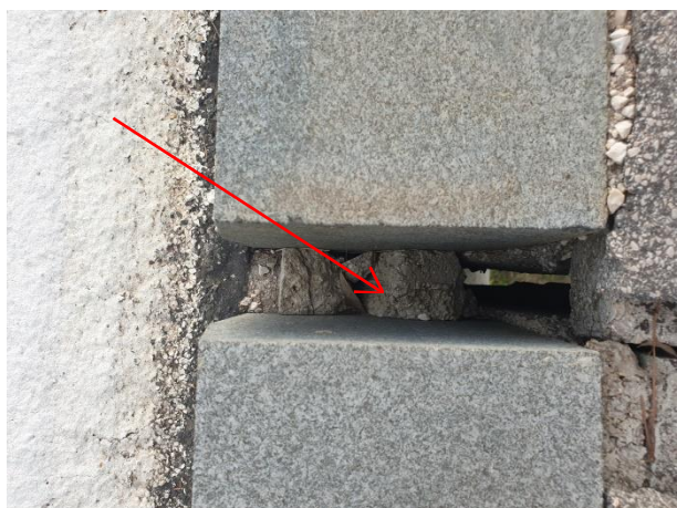
Slika 158. Nedostajanje mase za brtvljenje između rubnjaka. Stupanj oštećenja S4.
