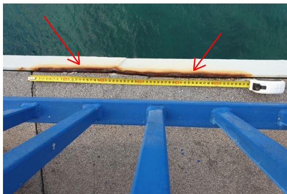
Slika 166. Korozija maske. Stupanj oštećenja S3.
