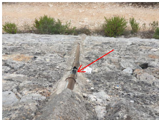
Slika 182. Oštećenje zaštitne cijevi za strujne kablove na upornjaku U1.
