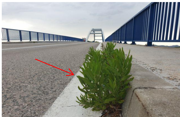
Slika 136. Vegetacija na rubu asfaltnog sloja i rubnjaka. Stupanj oštećenja S2.
