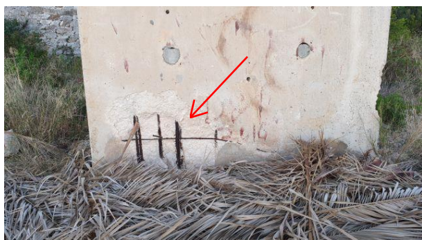
Slika 88. Korozija armature u segregiranom dijelu stupa S2. Stupanj oštećenja S4.
