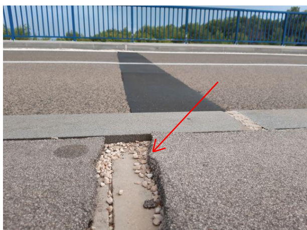
Slika 140. Pukotina u blizini prijelazne naprave. Stupanj oštećenja S4.
