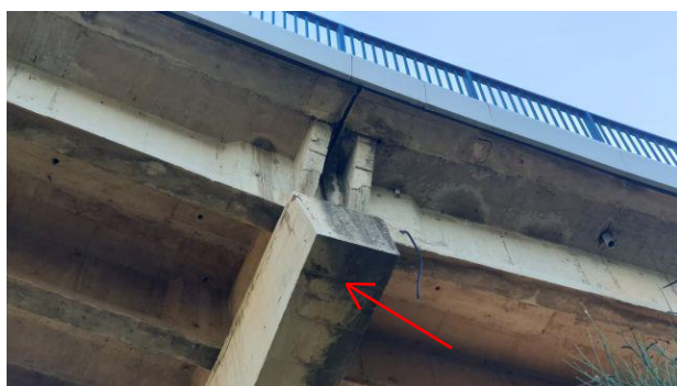
Slika 100. Naglavnica stupa S9 – delaminacija betona uslijed vlaženja. Stupanj oštećenja S3.
