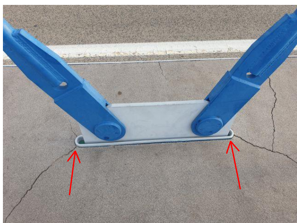
Slika 146. Pukotine uz vješaljke glavnog nosača. Stupanj oštećenja S4.
