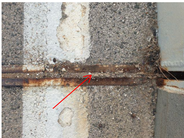
Slika 121. Propadanje prijelazne naprave zbog lošeg održavanja. Stupanj oštećenja S2.
