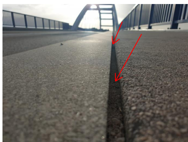
Slika 161. Propadanje mase za brtvljenje između asfalta hodnika i rubnjaka. Stupanj oštećenja S3.
