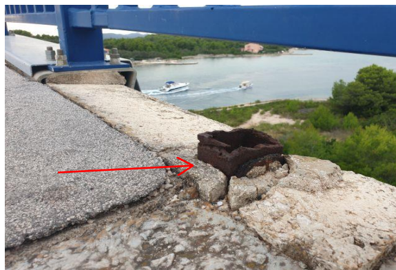
Slika 167. Odlamanje betona na mjestu stare ograde uzrokovano korozijom. Stupanj oštećenja S3.
