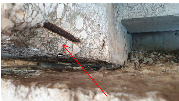
Slika 130. Oštećenja konstrukcije neposredno uz ležaj na upornjaku U1. Stupanj oštećenja S3.
