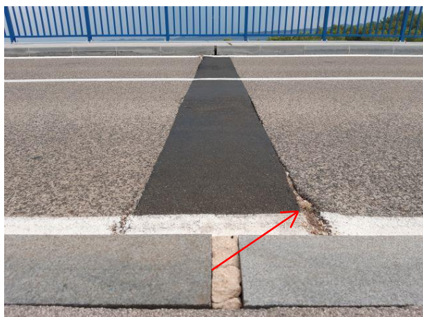
Slika 126. Propusnost bitumenske dilatacijske naprave. Stupanj oštećenja S3.
