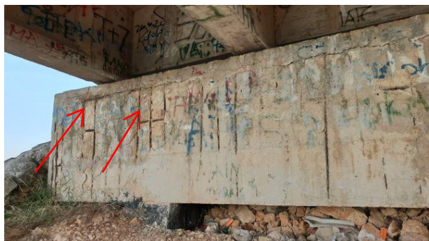
Slika 92. Upornjak U1 – nedovoljan zaštitni sloj betona. Stupanj oštećenja S4.
