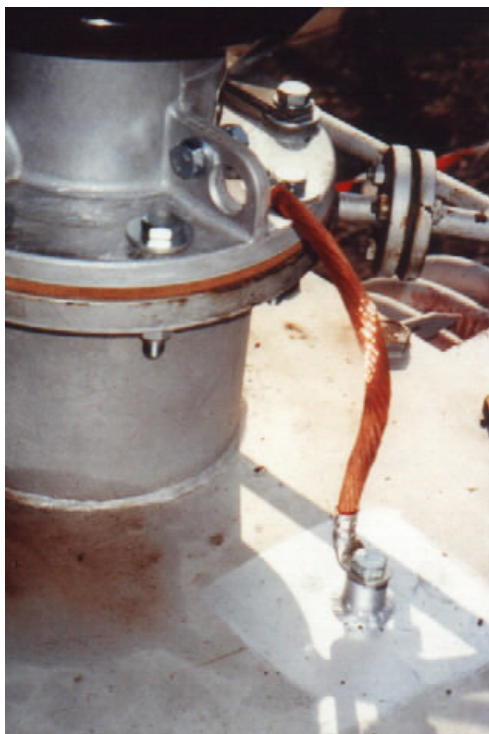
Slika 2. Spoj provodnika i kotla u pogonu s odgovarajućom pletenicom
