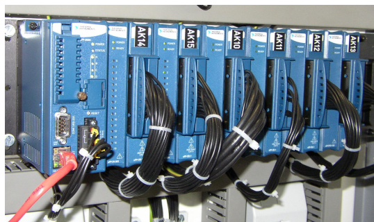
Slika 3. Kontroler sustava motrenja
