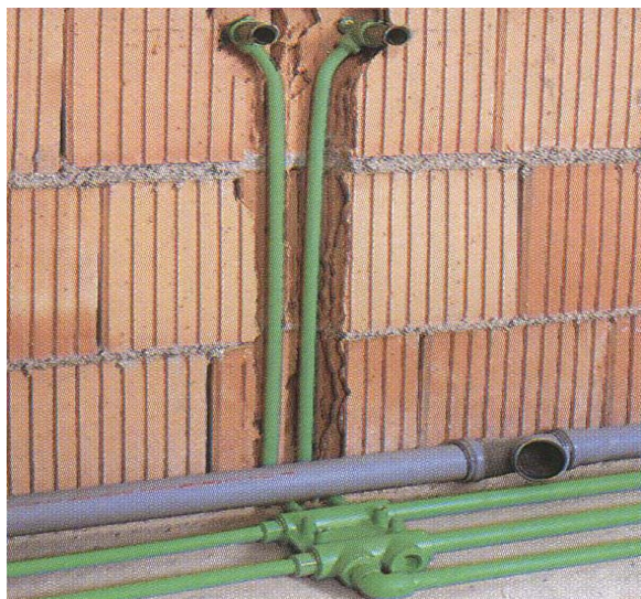
Slika 1. Cjevovod pitke vode izrađen od PP-R 80 [1]
