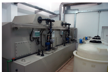
3. Uređaj za prčišćavanje zraka
