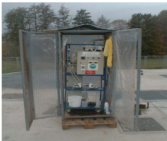
Slika 1. MBR Pilot uređaj za obradu otpadne vode
