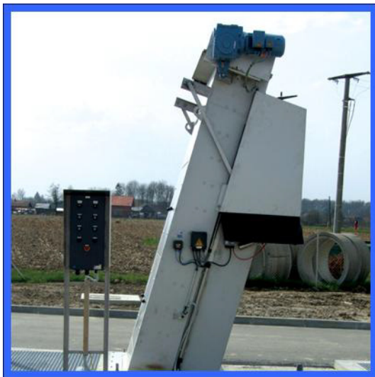
Slika 1. Automatska gruba rešetka
