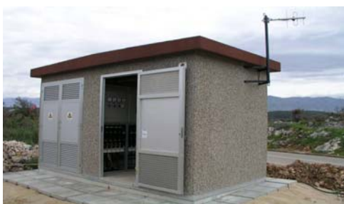
Slika 7. Kabelska trafostanica 10(20)kV
