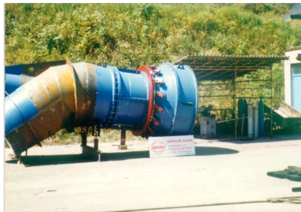
Slika 3. Turbina u MHE Modrac
