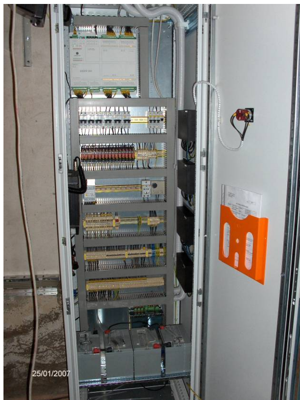
Slika 10. Ormar daljinskog upravljanja u TS 10(20)/0,4kV
