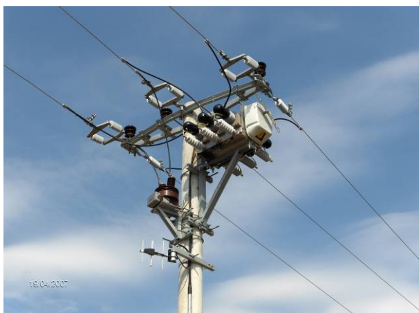
Slika 4. Rastavna sklopka, naponski transformator i usmjerena antena na dalekovodnom stupu
