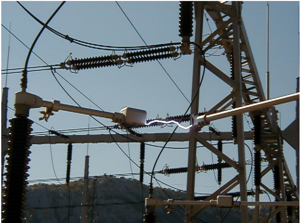
Slika 10 Isklop rastavljača u mjernom polju 220 kV
