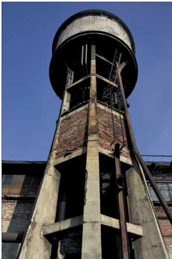
- OLT, vodotoranj, foto Krešimir Lendić
