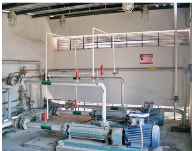
Slika 3.2. Postrojenje u prostoru ugroženom eksplozivnom atmosferom
