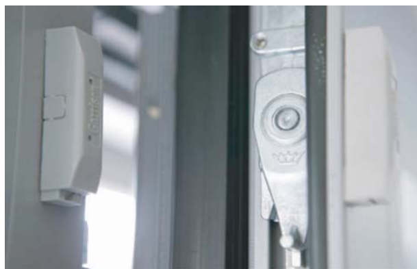
Mikroprekidač na prozoru prilikom otvaranja radi ventilacije isključuje sustav grijanja i hlađenja i tako štedi energiju / Izvor: EIHP
