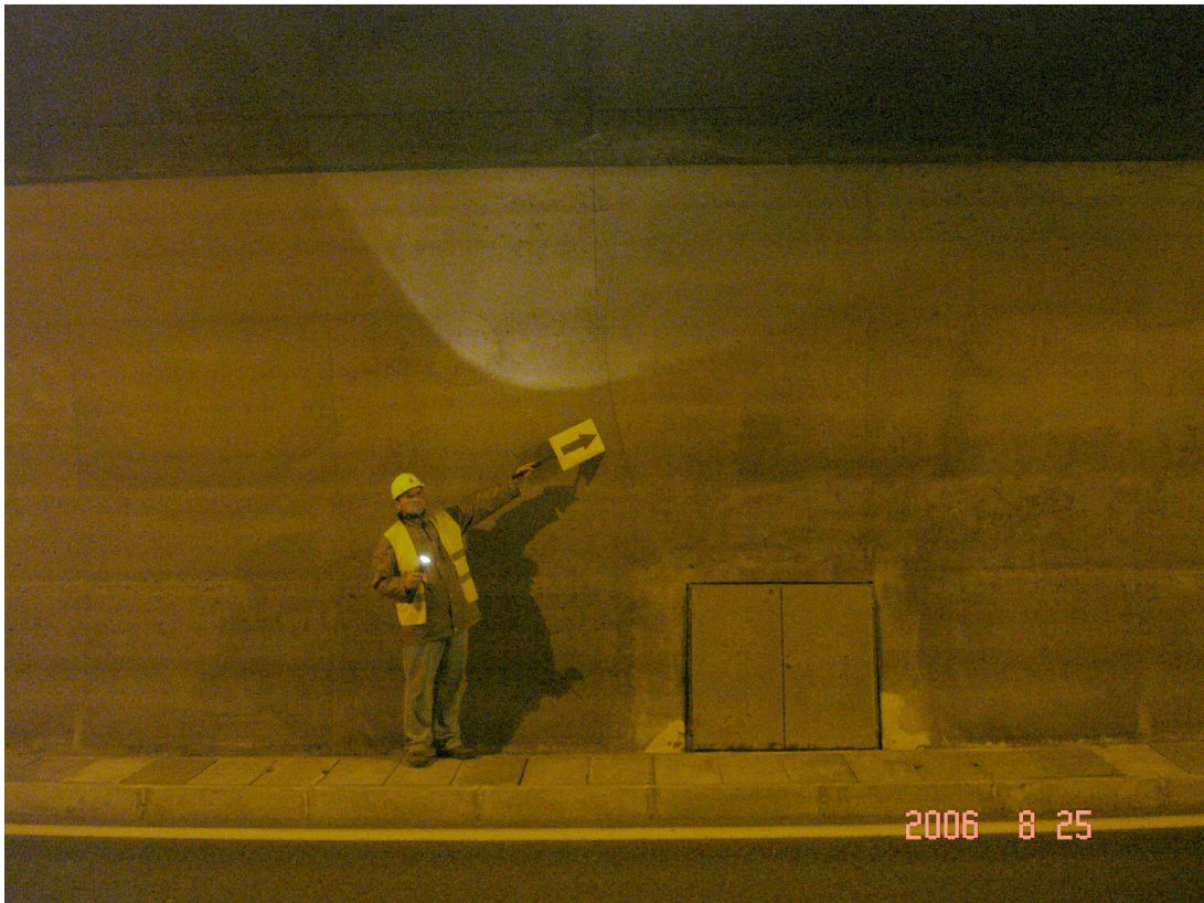
Slika 13. Pukotina u desnom boku sekundarne obloge
