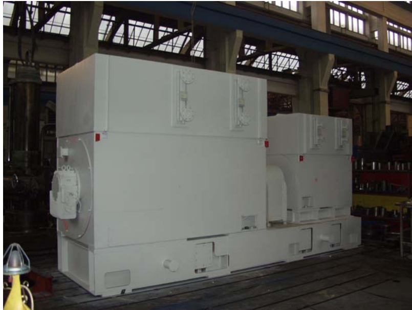
Slika 3. Montirani agregat 5 MVA u tvornici
