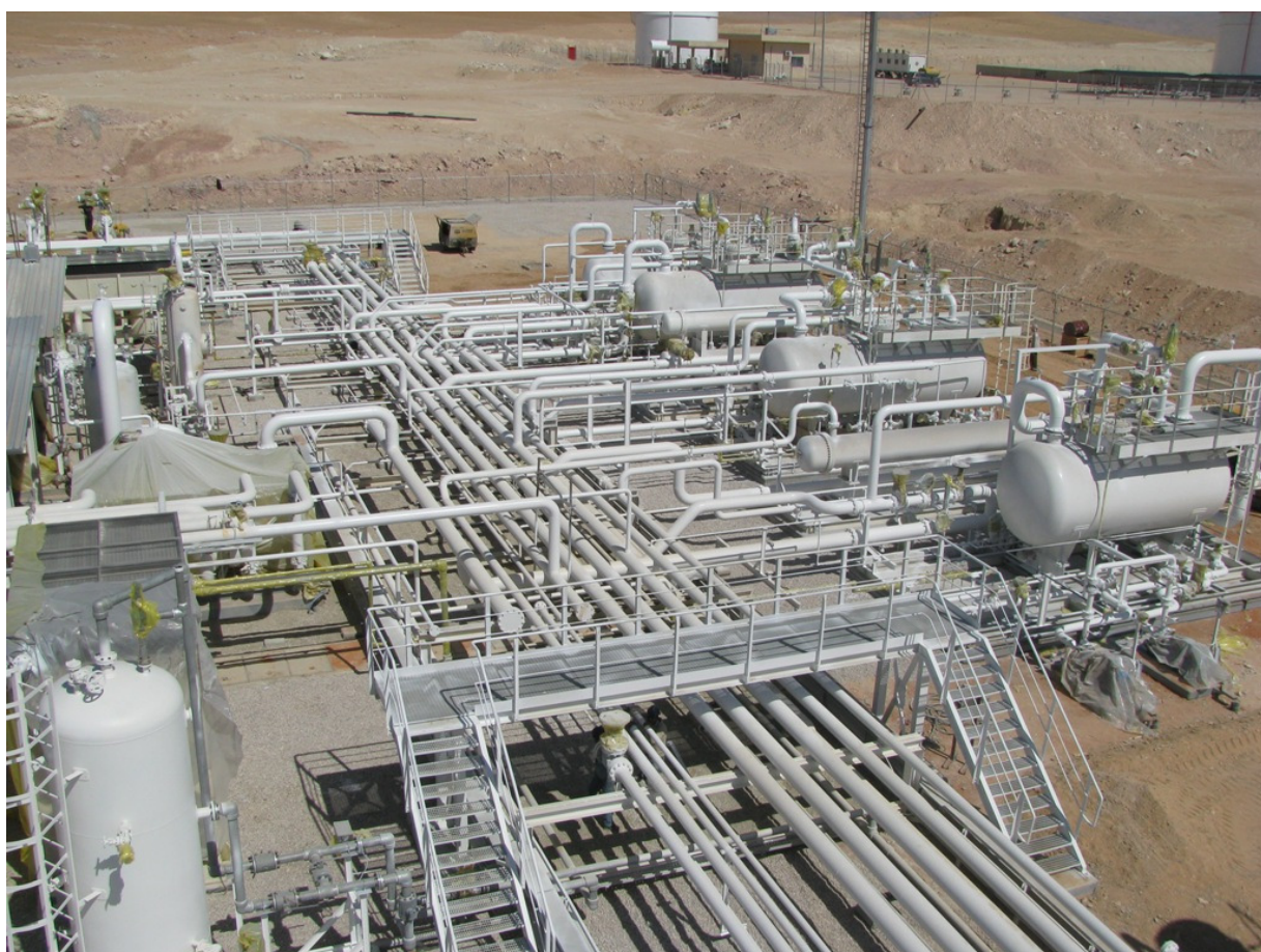
Slika 5.2 Postrojenje Jihar Faza 2 u Siriji
