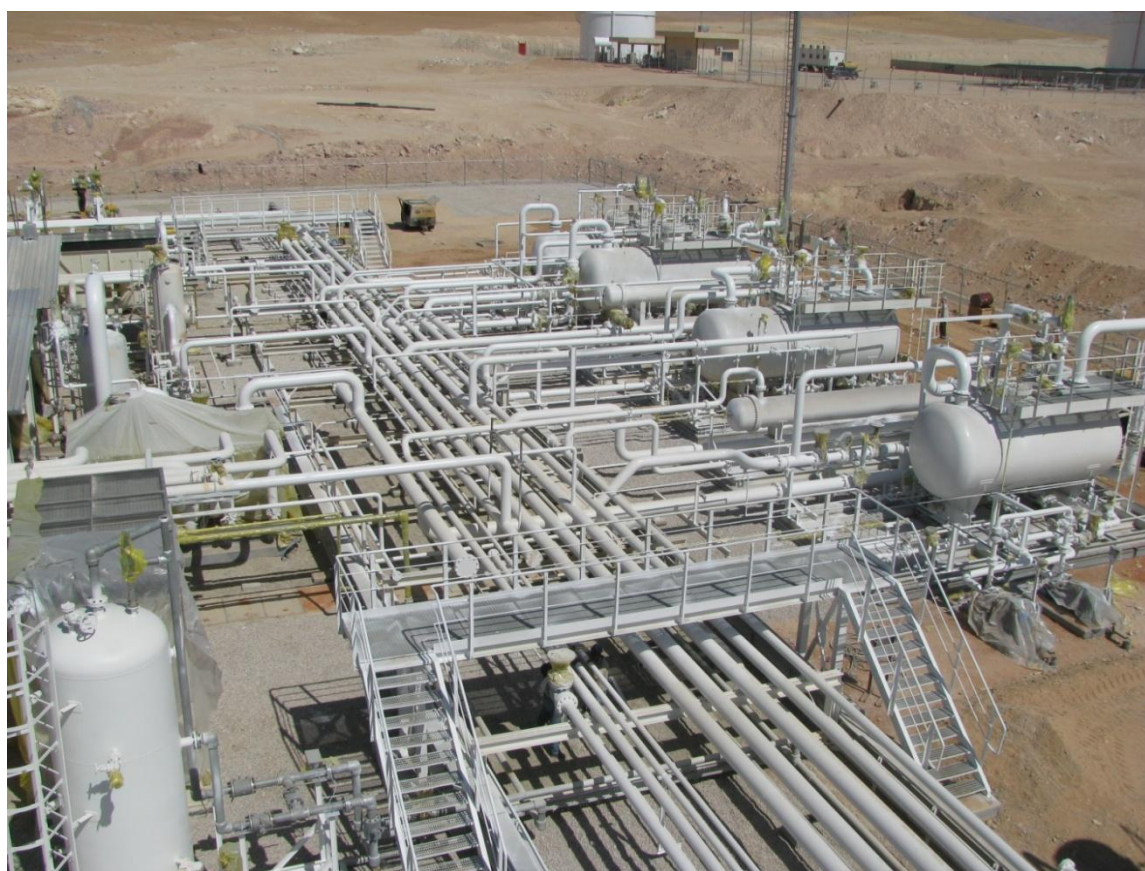
Slika 1.2 Postrojenje Jihar Faza 2 u Siriji
