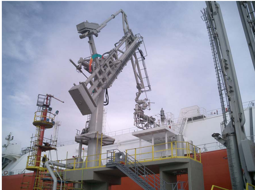
Slika 3-10. Istakačke ruke na obalnom priključku (Proštenik; Frančić 2011).
