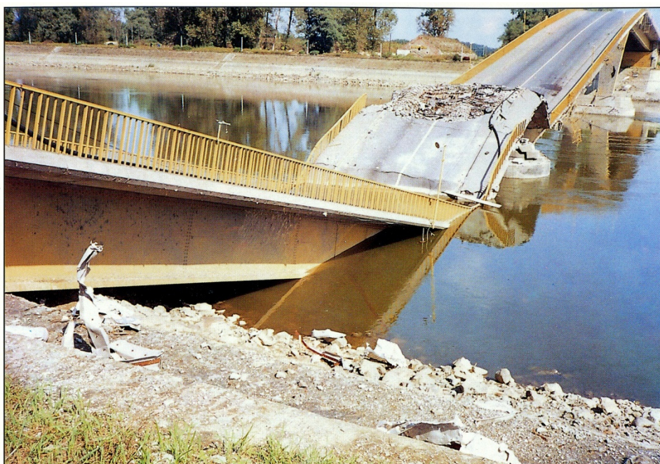
Na mostu preko Drave kod Osijeka srušena je rasponska konstrukcija u duljini od 202 metra. Oštećeni su riječni stupovi i upornjaci mosta.
