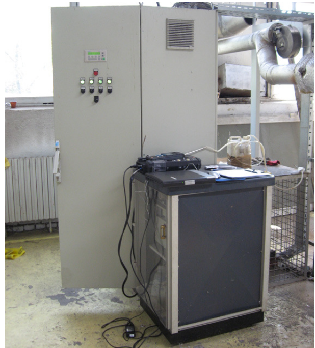
Slika 6.38. Kontrolni ormar sa Siemens Simatic PLC uređajima i TESTO analizator dimnih plinova
