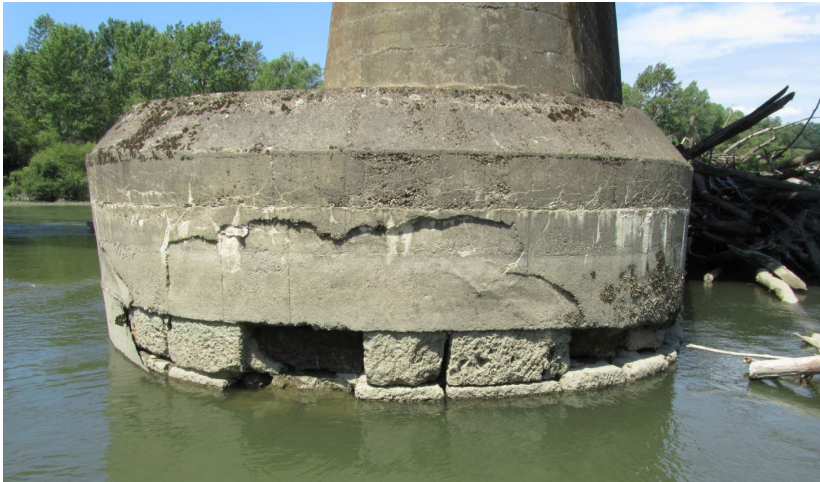
Slika 7. Nizvodno lice stupa - nedostaje nekoliko kamenih blokova te je uništena oplata čeličnog kesona
