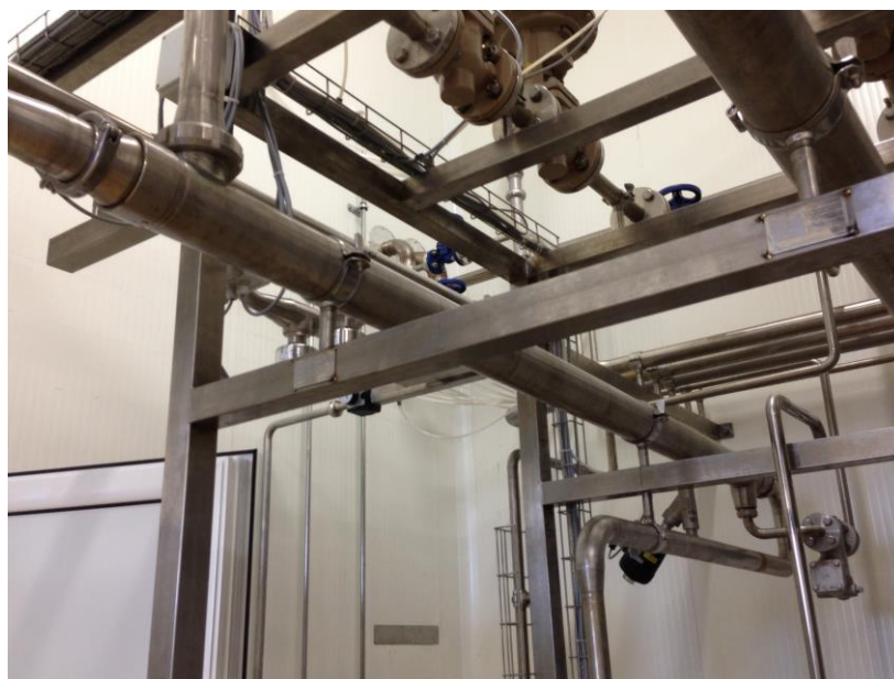
Slika 2.2. Cijevni grijač koji se korišten u postrojenju
