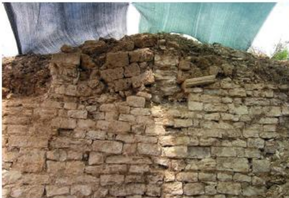
Sl. 6. Zid sjevernog prolaza s ostacima kamenih i sedrenih dijelova svoda in situ
