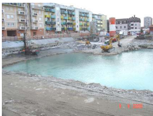
Slika 10 Potopljena jama netom prije izvedbe sanacije stupnjaka
