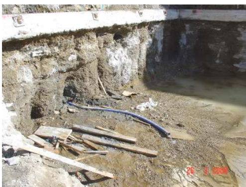
Slika 6 Mjesto prodora vode nakon hitne sanacije istoga
