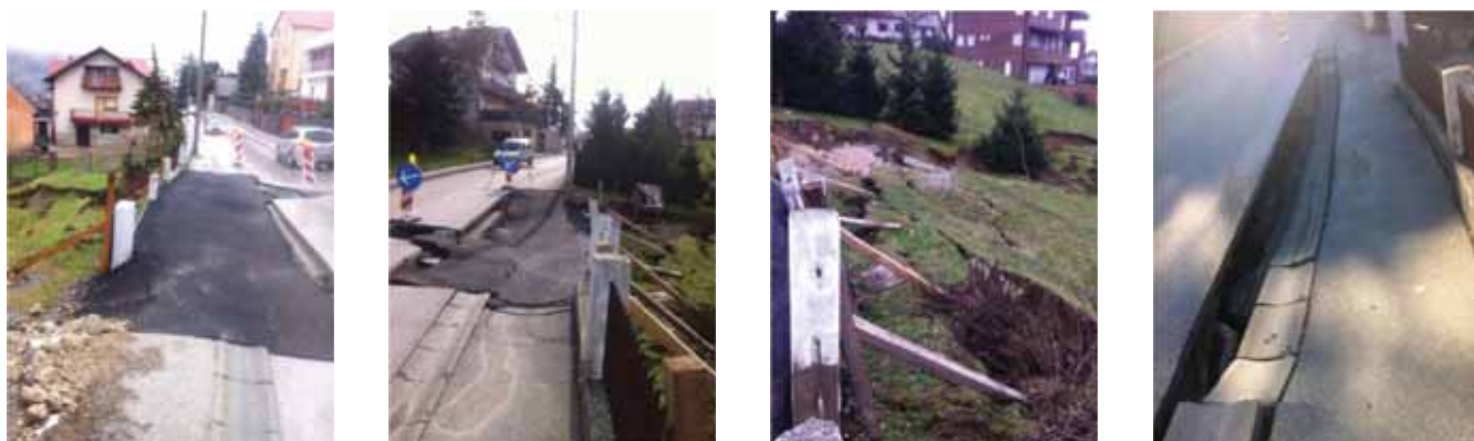
Slika 12 Asfaltiranje ulice u Šestinama oštećene klizanjem fotografirano je 12.2.2013, zatim se vidi stanje 15.2., te 19.4. Najdesnija fotografija pokazuje propali kanal koji – umjesto da vodu odvodi od prometnice i kosine – vodu skuplja i ulijeva u kosinu (Šelaj, 2014).
