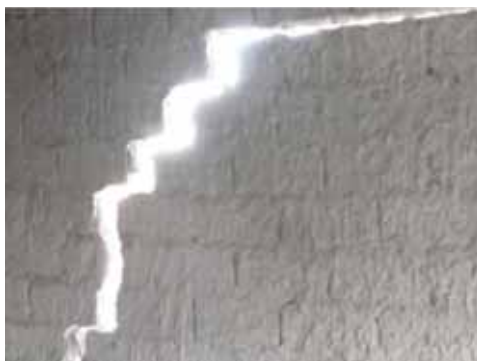
Slika 4 Zid kuće na klizištu (Tepeš, 2013)
