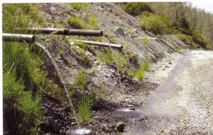
Slika 19 Izlazi vodoravnih bušenih drenova
