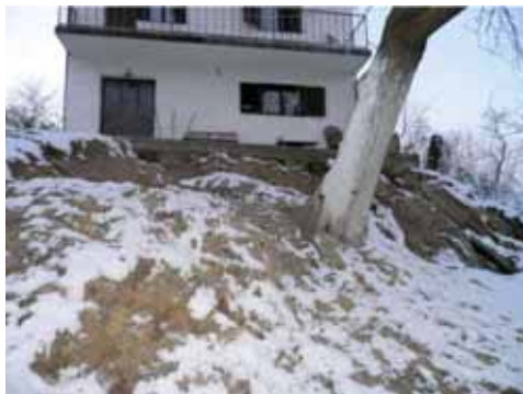
Slika 5 Kuća na rubu klizišta (Miklenić, 2011)
