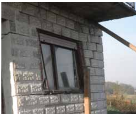
Slika 3 Zid kuće na klizištu (Tepeš, 2013)
