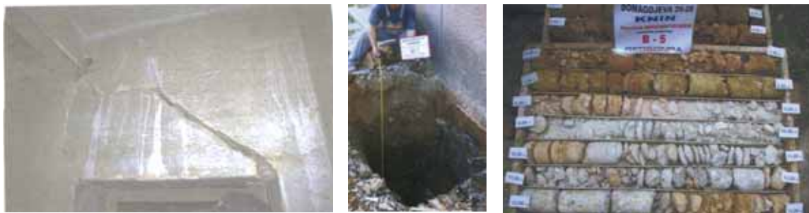
Slika 10 Oštećena zgrada, sondažna jama uz zgradu i uzorci iz jedne od bušotina uzeti radi osiguranja stabilnosti u budućnosti (Lončar, 2013)
