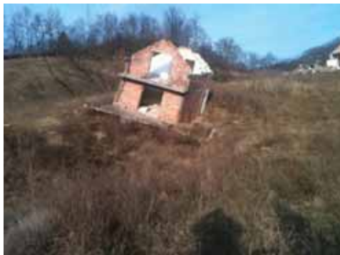
Slika 2 Kuća na klizištu (Antolović, 2012)
