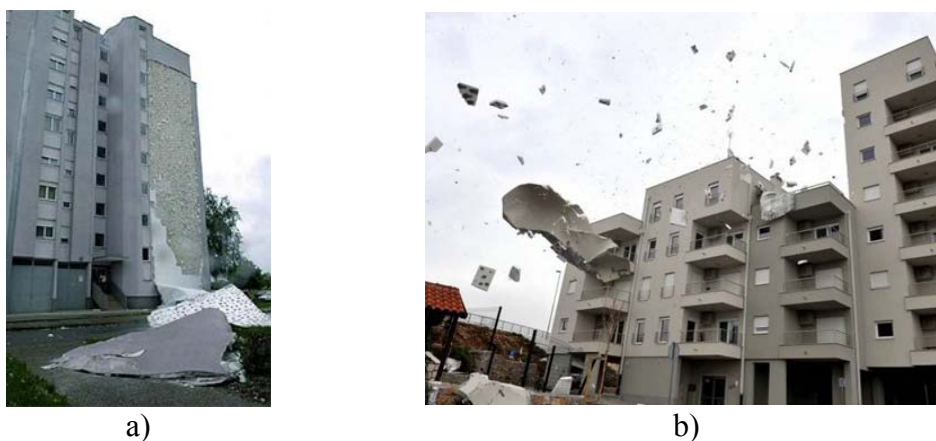
Slika 3 Građevinska šteta uzrokovana neadekvatno ugrađenim ETICS sustavom, a) Vukovar, svibanj 2010. [19]; b) Rijeka 5. ožujak 2015. [20]
