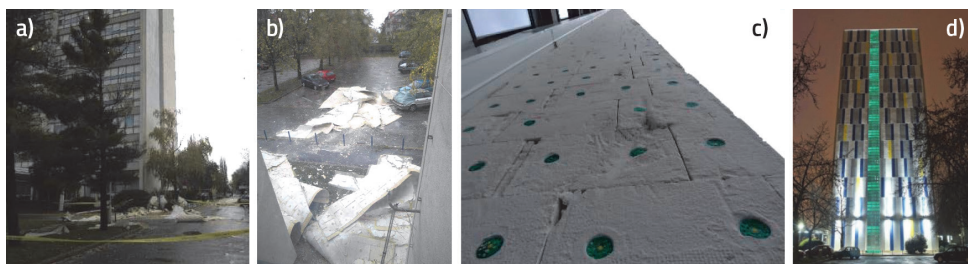
Slika 12. a-c) fotografije štete na fasadi nastale nakon energetske obnove, d) fotografija fasade nakon sanacije
