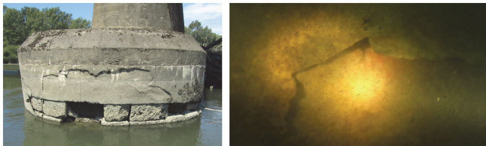
Slika 4. Oštećenja čelične oplata kesona i kamene ispune (lijevo); snimka pod vodom (desno)
