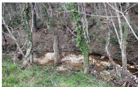
Erozija bočnih pokosa kanala na nizvodnom dijelu rijeke
