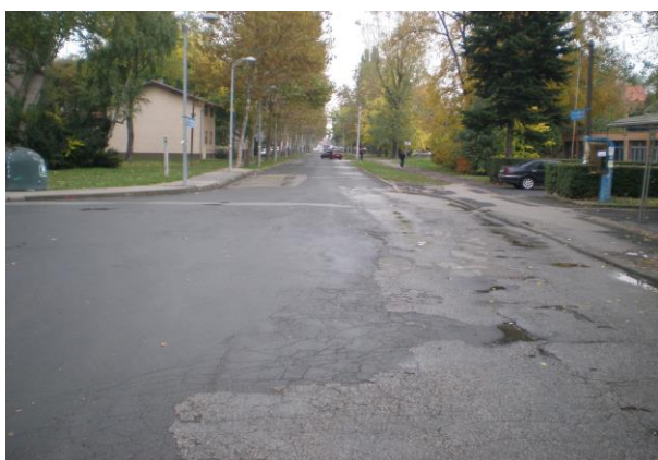
Sl. 1. Detalj nerazvrstane ceste na kojem postoji potreba izvanrednog održavanja
