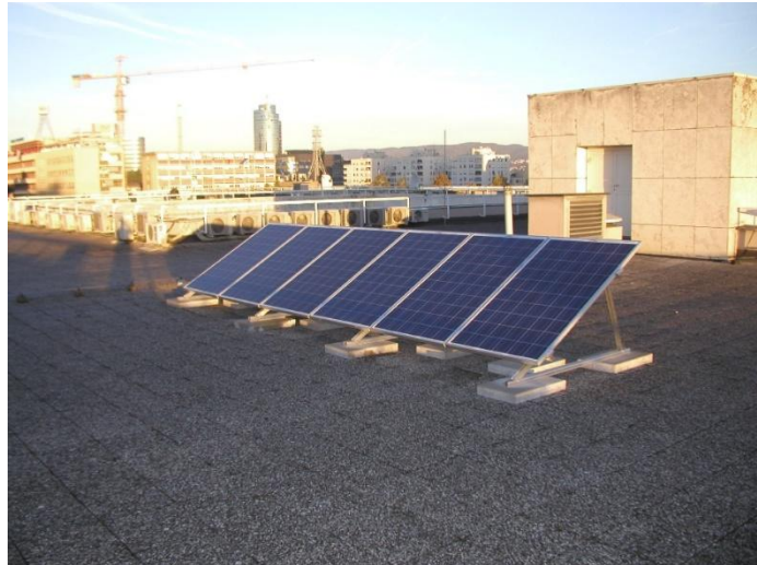
Slika 4. Solarni paneli instalirani na krovu
