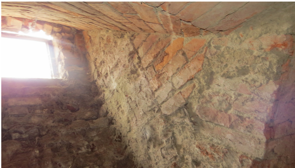
Ulični podrumski prozor, vidljivi tragovi štemanja i naknadnog zazidavanja
