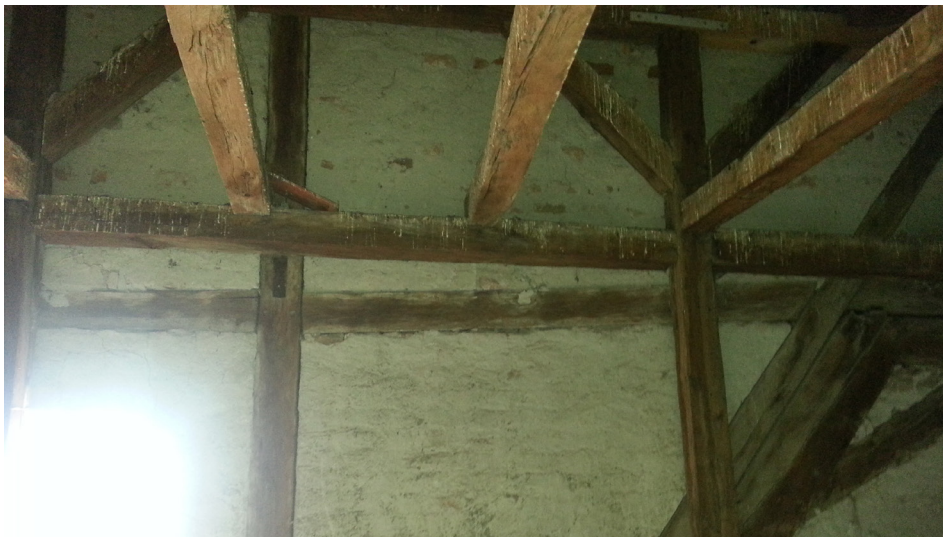
Ostatci prvotne krovne konstrukcije u zapadnom zabatu
