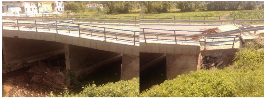
Slika 10. Most Đurmanec: a) nagomilani plutajući nanos u središnjem otvoru mosta (lijevo); b) erozija obale iza upornjaka (desno) / Autor: M. Skazlić
